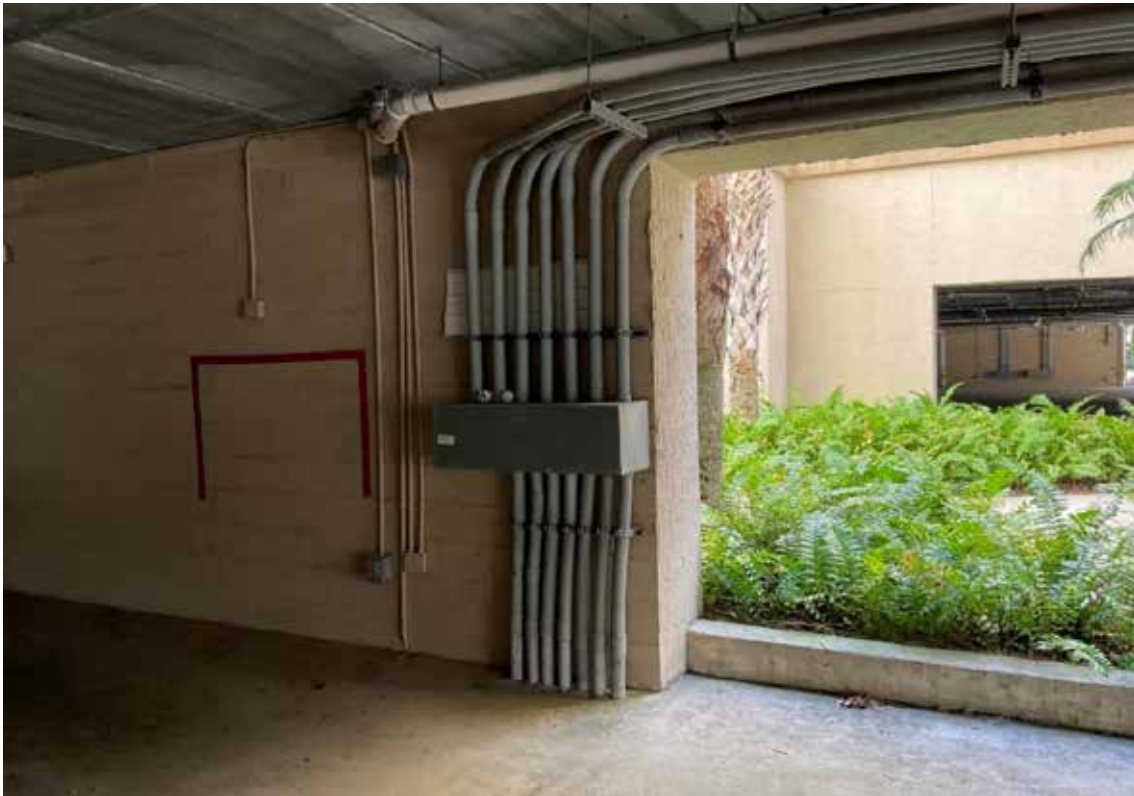
Bldg 200 - Electrical Conduit
