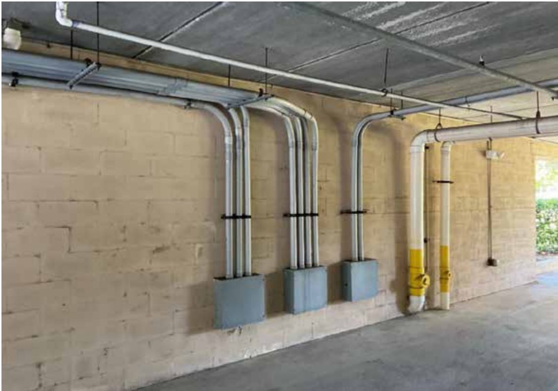
Bldg 100 - Electrical Conduit
