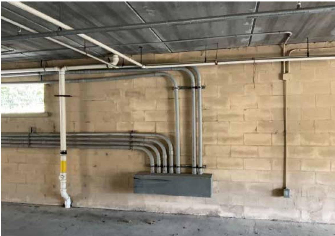
Bldg 300 - Electrical Conduit
